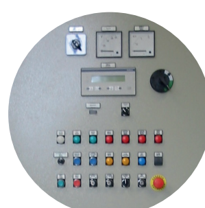
Armoire électrique CE
